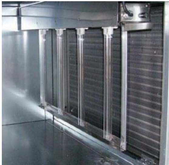
Малюнок 3. Бактерицидна установка, яка розташована всередині повітроводу.
